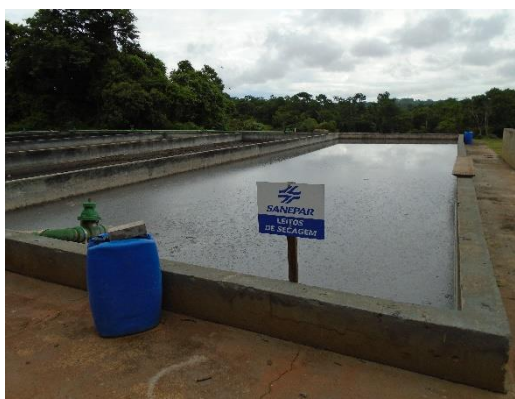
Foto 10 – Leitos de secagem.
