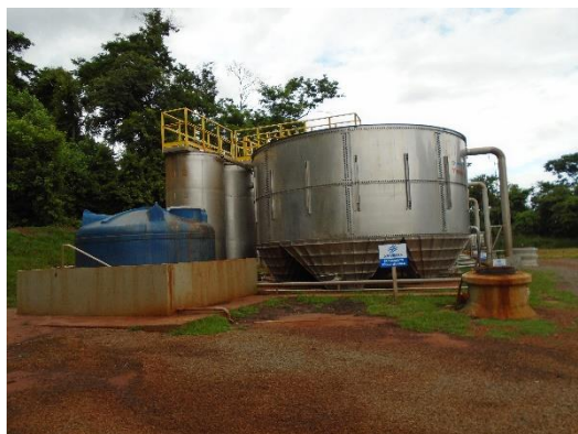
Foto 11 – Sistema físico-químico (coagulação, floculação e decantação).
